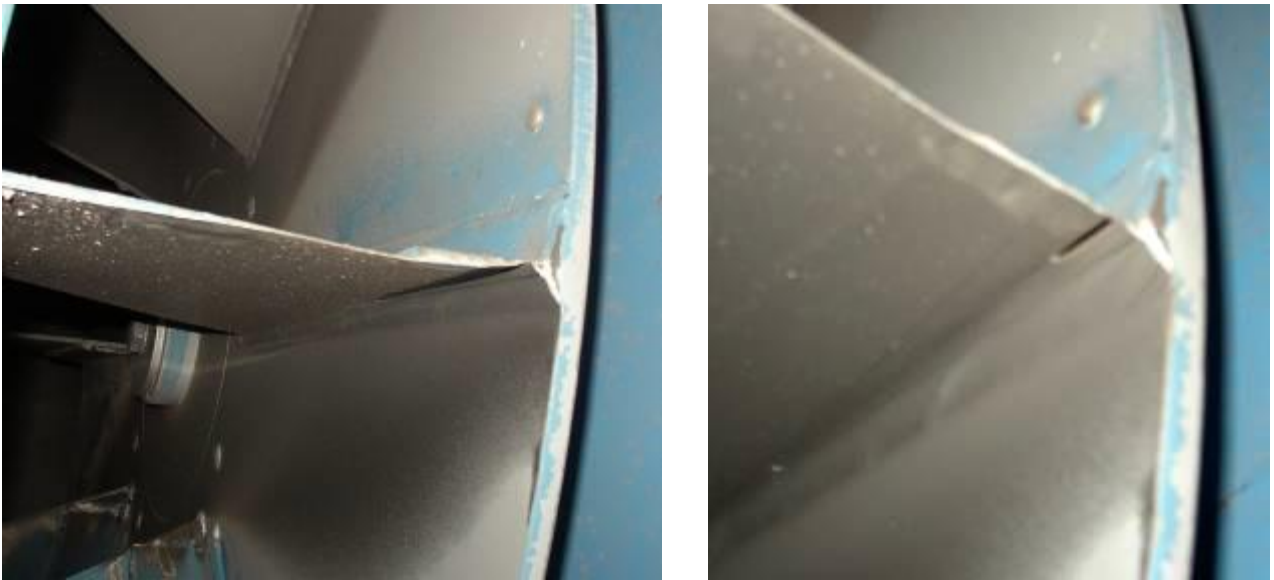
Рисунок 2 – Неравномерный эрозионный износ лопаток рабочего колеса
