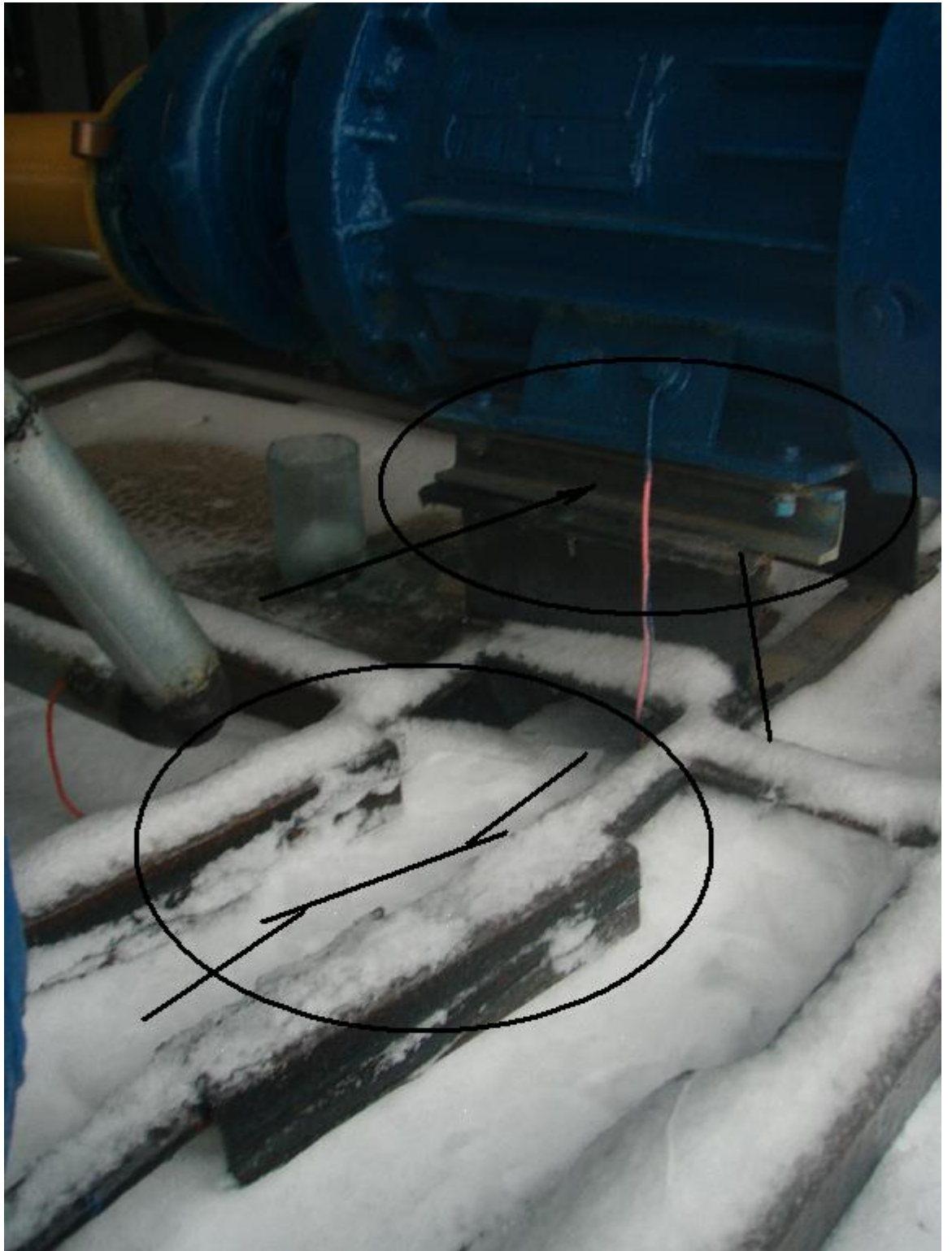
Рис. 54. Агрегат №22 (№13, ст. 1, 6НКЭ-9х1, блок раздаточного пункта налива ГСМ-1)
