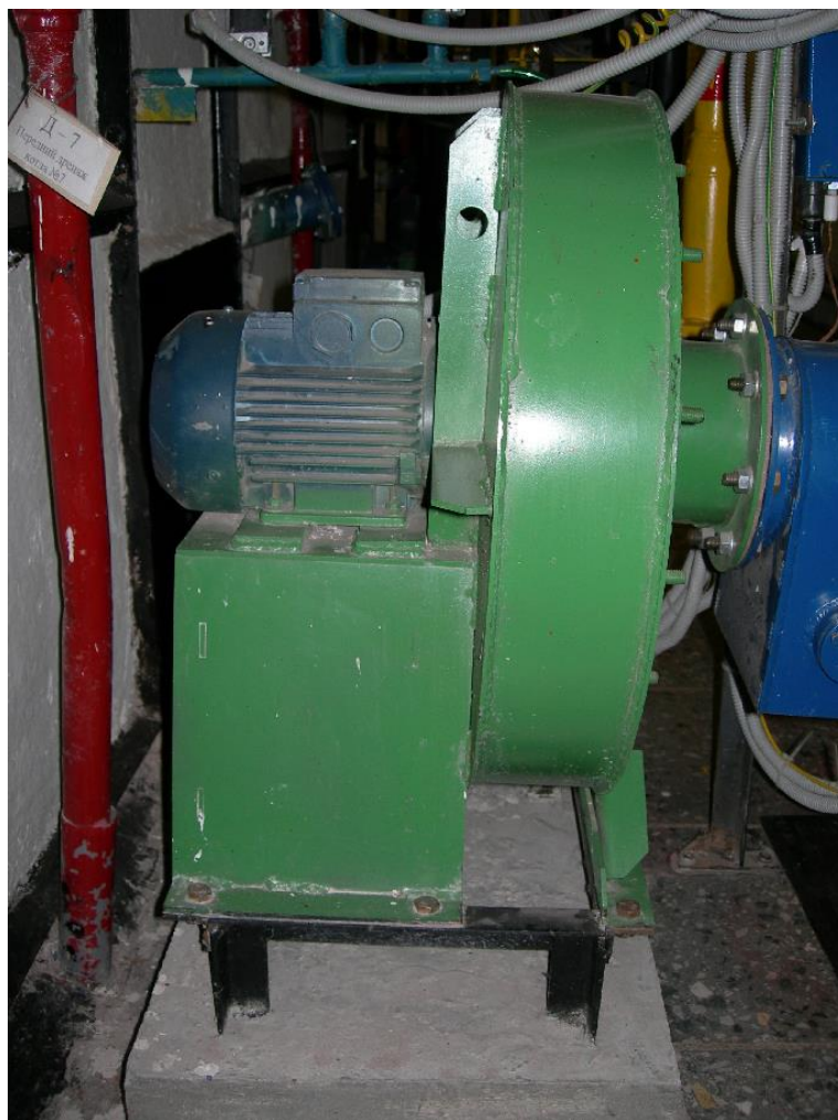
Рис. 2. Внешний вид вентиляторной установки
